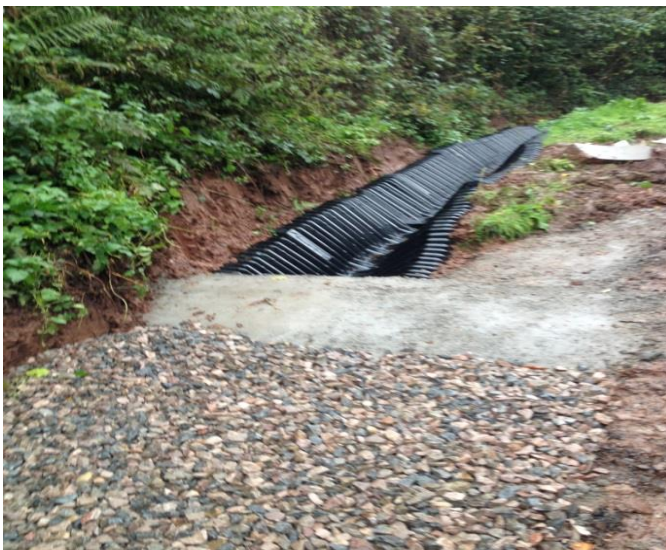
El SmartDitch desagua en el alcantarillado en un apartadero
